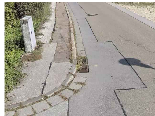
EINSEITIGER GEHWEG, ZU SCHMAL FÜR ROLLATOR ODER ROLLSTUHL, ABSENKUNG PROBLEMATISCH (-) (VITUSPLATZ)
